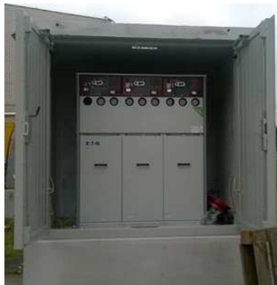
Rys. 1 Złącze kablowe typu ZK-SN-18 z rozdzielnicą Xiria
